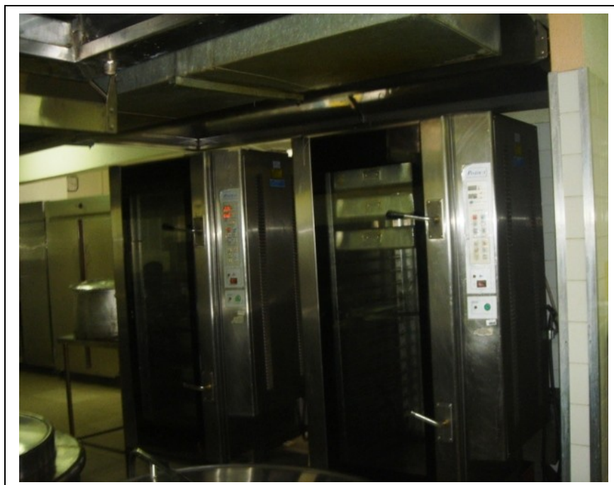
Figura 5: Forno combinado utilizado para preparo e /ou aquecimento de diversos alimentos
