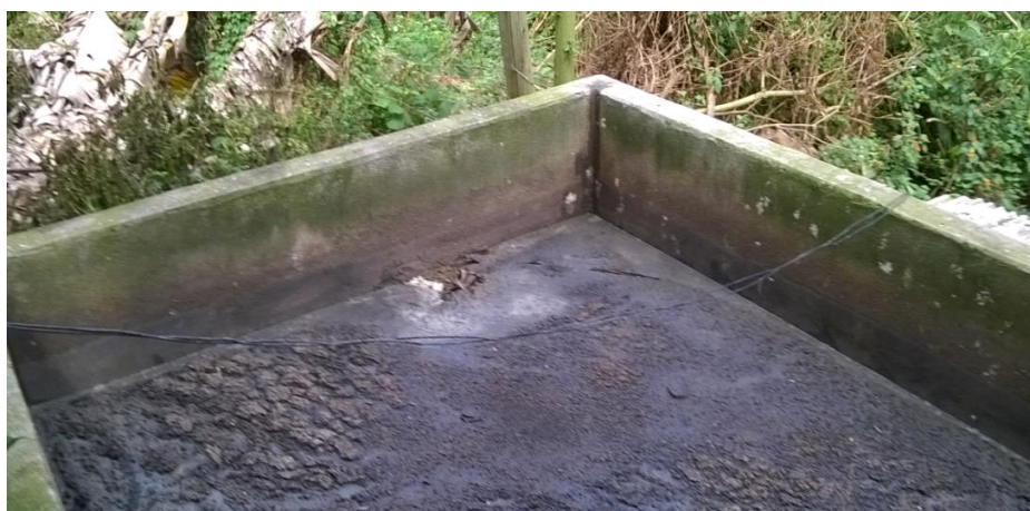
Figura 9 – Granja G1: caixa de captação dos dejetos
