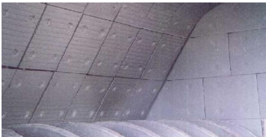
Figura 9 - Imagem interna do britador do clínquer
